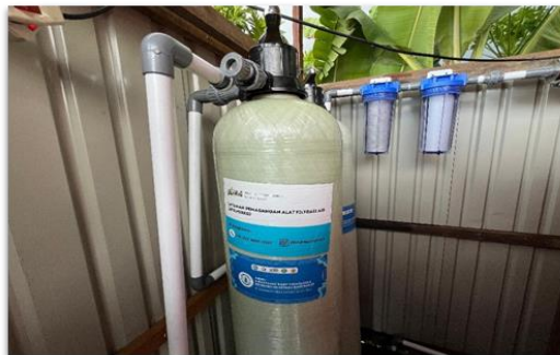
Gambar 3. Rangkaian Alat filtrasi pengolahan air sungai menjadi air bersih
