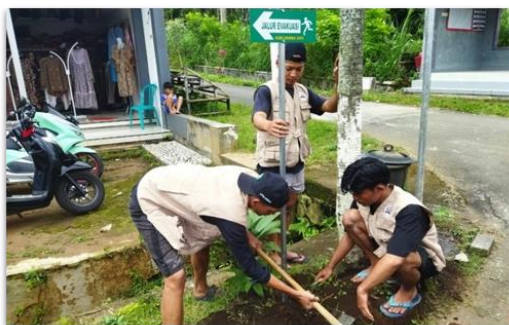
Gambar 1. Pemasangan plang jalur evakuasi
